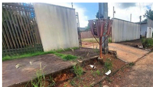
Foto 62 - Detalhe da calçada externa, demonstrando a total falta de acessibilidade do pedestre, bem como a exposição da base da lixeira e poste de energia elétrica
