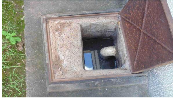
Foto 55 - Detalhe da caixa de gordura (cozinha), que demonstra boas condições de manutenção e limpeza, porém situada muito próxima à saída de águas pluviais
