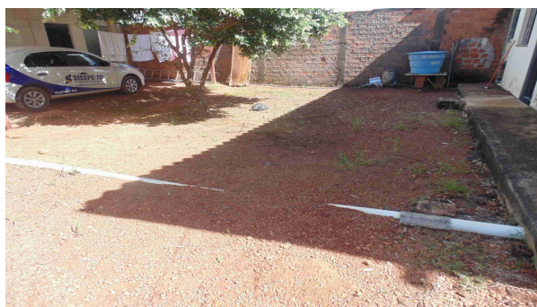
Foto 39 - Vista geral da área central a ser pavimentada, onde se demonstra a tubulação de esgoto exposta às intempéries e sem a devida inclinação de escoamento
