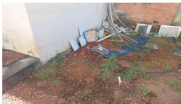
Foto 42 - Detalhe dos entulhos existentes no terreno, que devem ser retirados, tendo em vista a necessidade de ampliação da calçada de proteção contra a umidade
