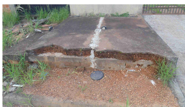
Foto 02 - Detalhe da calçada externa sobre a laje da fossa séptica, que deve ser demolida para nivelamento do passeio público em conjunto com rampa de acesso
