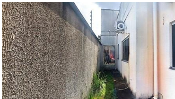
Foto 68 - Detalhe do muro (jardim lateral), revelando muitas manchas de pintura por ação das intempéries, sendo indicada a pintura texturizada com tinta acrílica
