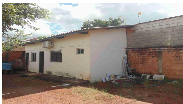
Foto 40 - Vista do bloco de alojamentos dos fundos, que apresenta diversas trincas no reboco externo e pintura nas paredes externas danificadas pela umidade
