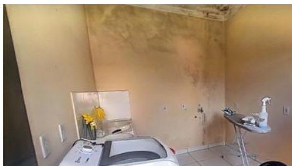
Foto 71 - Vista da Área Serviço do bloco dos fundos, que revela a pintura do forro e das paredes danificadas devido a infiltrações do telhado e do muro dos fundos
