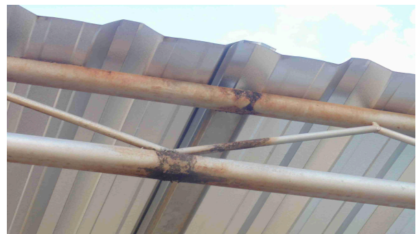
Foto 12 - Detalhe da treliça plana metálica na varanda frontal, sendo necessária a recuperação de trechos com ferrugem e pintura com tinta esmalte sintético
