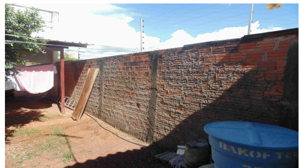
Foto 48 - Vista do muro lateral próximo à área central a ser pavimentada, cuja altura deve ser nivelada junto à cobertura da garagem existente (estrutura e alvenaria)
