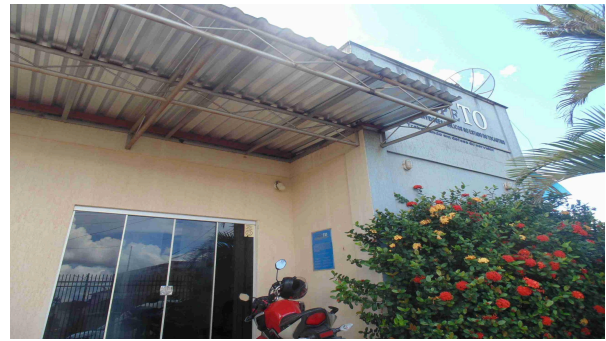
Foto 08 - Vista geral do telhado da varanda frontal, onde se revelam treliças planas metálicas com pintura visivelmente danificada e possíveis pontos de ferrugem
