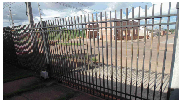
Foto 30 - Detalhe do portão/gradil frontal na rampa de acesso ao Edifício Sede da Regional Sul, onde se indica o mesmo tratamento com lixa e pintura pistola
