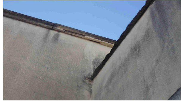
Foto 56 - Detalhe da platibanda do telhado junto ao gramado, cujas pingadeiras apresentam-se quebradas, sendo necessária substituição total e pintura externa
