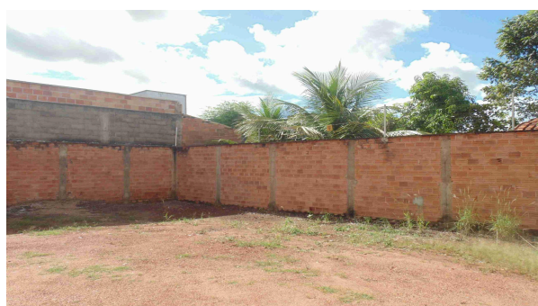
Foto 22 - Vista interna do canto do muro existente, mais especificamente do muro lateral e fundos do lote, que não apresenta nenhuma proteção contra umidade
