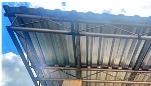
Foto 65 - Detalhe do telhado da varanda frontal, onde nota-se a ausência da calha de coleta de águas pluviais, ocasionando a queda de chuva diretamente na varanda
