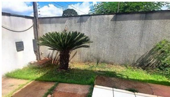
Foto 67 - Vista do gramado lateral, cujas pingadeiras do muro apresentam-se completamente soltas ou danificadas, sendo necessária a substituição de todas
