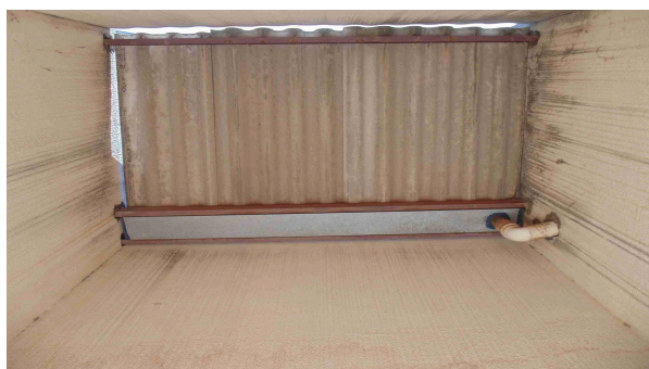
Foto 59 - Detalhe do telhado da antiga Área Externa, que revela manchas na pintura de todas as paredes e ausência de pintura nos perfis metálicos da estrutura
