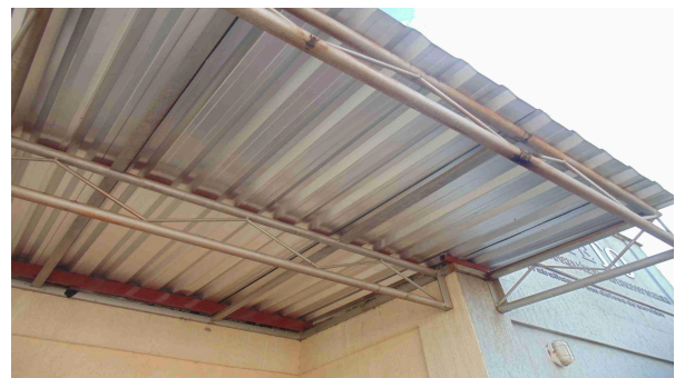
Foto 10 - Detalhe do telhado da varanda frontal, onde observam-se pontos danificados e pequenos trechos de novos perfis soldados ainda sem tratamento/pintura
