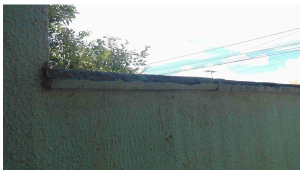
Foto 33 - Detalhe das pingadeiras instaladas no muro interno, que se apresentam completamente soltas ou danificadas, sendo necessária a substituição de todas
