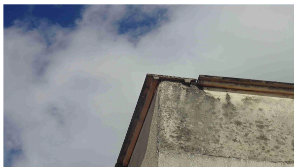
Foto 36 - Detalhe das pingadeiras instaladas acima das paredes da antiga A. Externa, que também se revelam danificadas, sendo recomendada a substituição total
