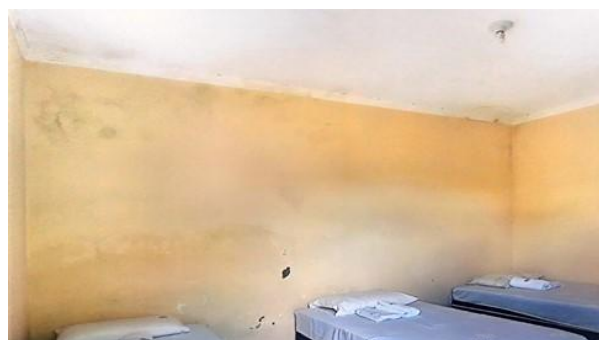
Foto 72 - Vista do alojamento masculino (fundos), que ressaltam a urgência da pintura do forro de gesso e de todas as paredes internas, inclusive forro do banheiro
