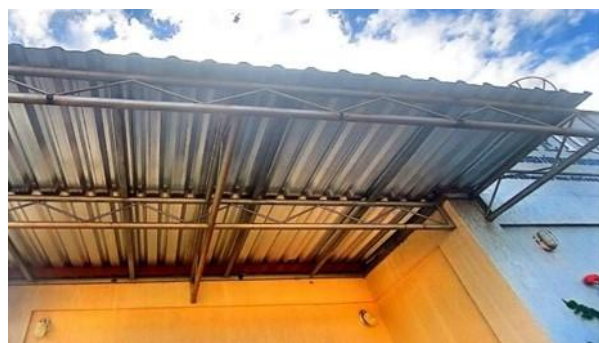
Foto 66 - Detalhe do telhado da varanda frontal e da fachada frontal, que necessitam de pintura em esmalte sintético (estrutura metálica) e tinta acrílica (paredes)
