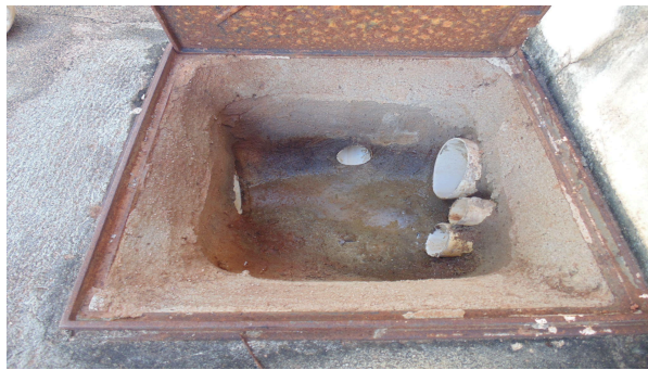
Foto 45 - Detalhe da caixa de esgoto mais próxima ao banheiro do bloco de alojamentos, a ser readequada para o redirecionamento do fluxo de esgoto sanitário
