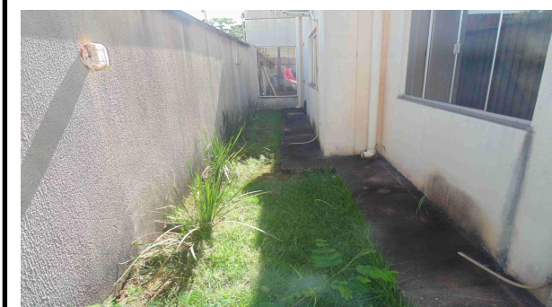
Foto 53 - Vista do gramado lateral do Edifício Sede da Regional Sul, onde deve ser prevista toda a canalização de águas pluviais (valas ou coletores prediais em PVC)
