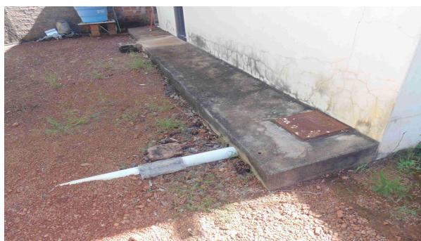
Foto 41 - Detalhe da calçada interna, caixa e ramal de esgoto do bloco de alojamentos dos fundos, sugerindo a ampliação da calçada e redirecionamento do esgoto
