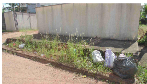
Foto 05 - Detalhe da calçada externa em frente ao muro/portão lateral, a ser demolida e reconstruída de acordo com o nível padronizado para todo o passeio
