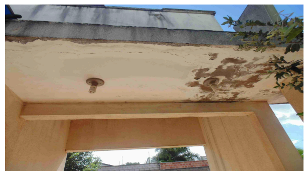
Foto 18 - Vista da laje em concreto armado acima da antiga Área Externa, onde se percebe a possibilidade de pontos de infiltração e degradação da laje existente
