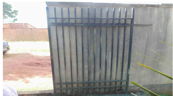
Foto 28 - Detalhe do portão de entrada lateral (gradil) que apresenta vão atual de 1,00m (largura), devendo ser 1,20m para oferecer acessibilidade ao público PNE
