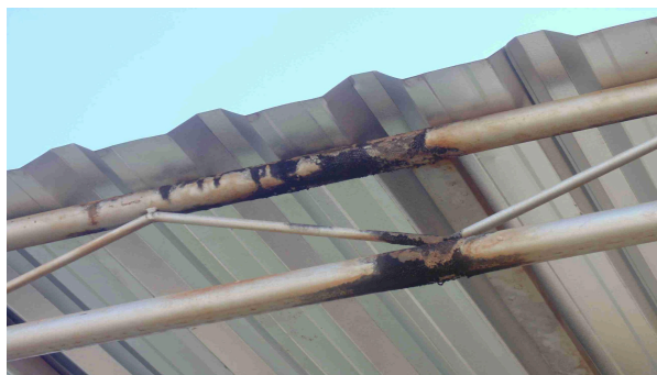
Foto 11 - Detalhe da treliça plana metálica na varanda frontal, sendo necessária a recuperação de trechos com ferrugem e pintura com tinta esmalte sintético
