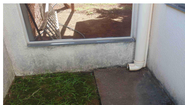
Foto 54 - Detalhe do trecho final do condutor vertical, revelando que as águas pluviais recolhidas no telhado são destinadas ao gramado sem a devida coleta predial
