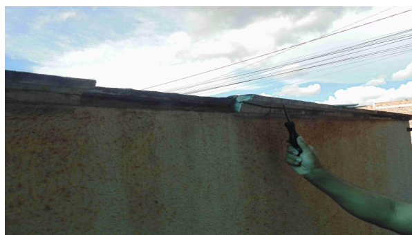
Foto 34 - Detalhe das pingadeiras instaladas no muro interno, que se apresentam completamente soltas ou danificadas, sendo necessária a substituição de todas
