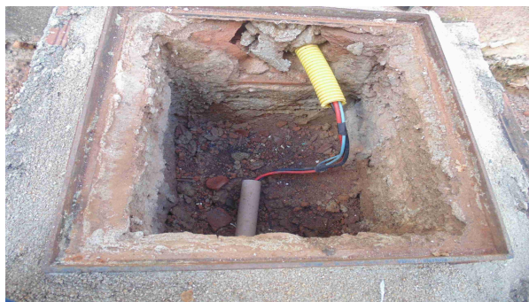
Foto 47 - Detalhe da caixa de passagem (elétrica), que deve receber uma camada de brita no fundo, evitando o contato direto entre condutores e umidade do solo
