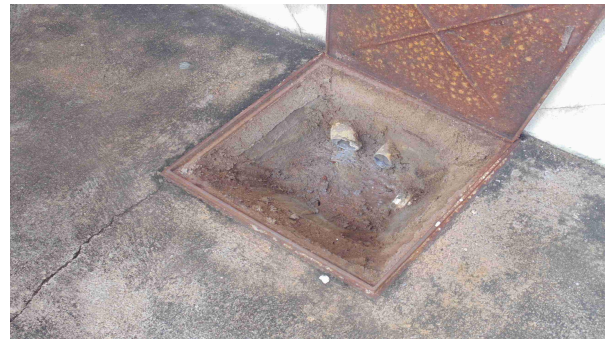
Foto 44 - Detalhe de caixa de esgoto da área serviço do bloco de alojamentos, devendo ser substituída para o redirecionamento do esgoto sanitário do banheiro
