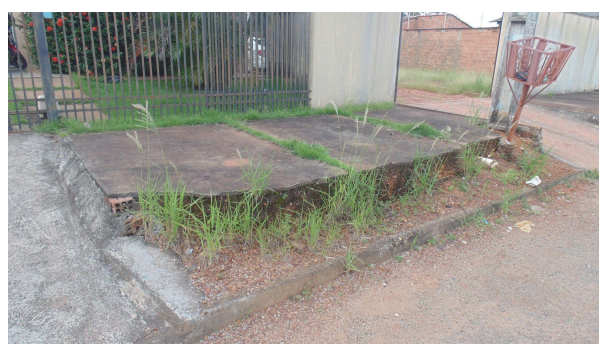
Foto 04 - Detalhe da calçada externa em frente ao portão central, que também deve ser demolida para nivelamento do passeio público e rampa de acesso
