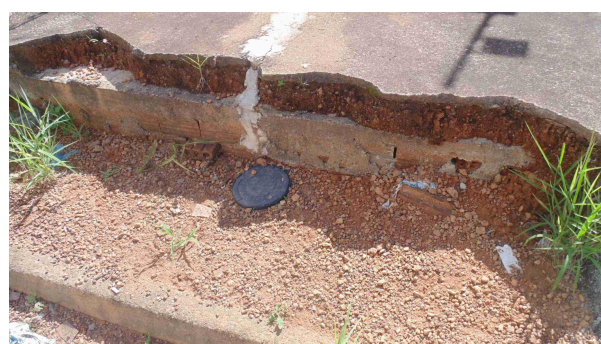
Foto 03 - Detalhe do piso cimentado a ser demolido para nivelamento do passeio público, considerando a caixa de aterramento do padrão de energia elétrica
