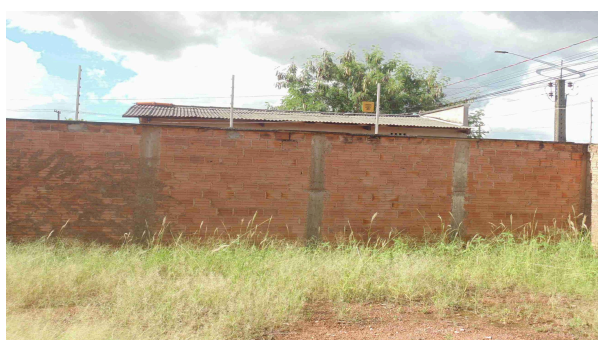
Foto 21 - Vista interna do muro lateral do lote, que demonstra uma aplicação superficial de chapisco em somente um pequeno trecho da alvenaria de tijolos
