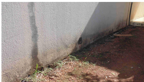
Foto 31 - Detalhe do muro interno entre a circulação de alojamentos e pátio de estacionamento, onde não se previu calçada de proteção contra umidade do solo
