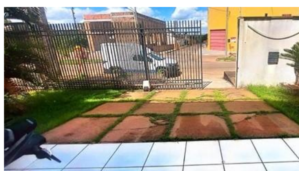
Foto 64 - Detalhe do piso da varanda e da rampa de acesso de pedestres, que apresentam boas condições, apesar de algumas placas de cimento comprometidas
