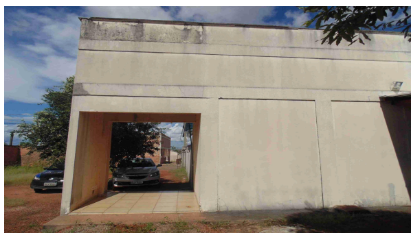
Foto 35 - Vista geral da fachada posterior do Edifício Sede da Regional Sul, que demonstra a necessidade de nova pintura em tinta acrílica na mesma cor existente
