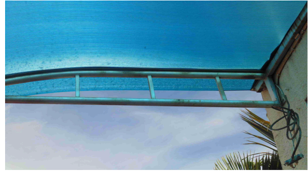
Foto 14 - Detalhe do apoio metálico de sustentação do toldo, sendo necessária apenas a padronização da pintura em esmalte sintético destas peças metálicas
