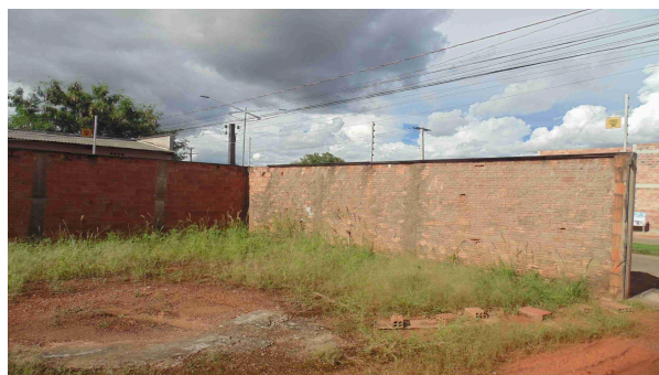
Foto 20 - Vista interna do muro frontal do lote, onde se observa uma aplicação superficial de chapisco na alvenaria de tijolos, sem proteção contra a umidade
